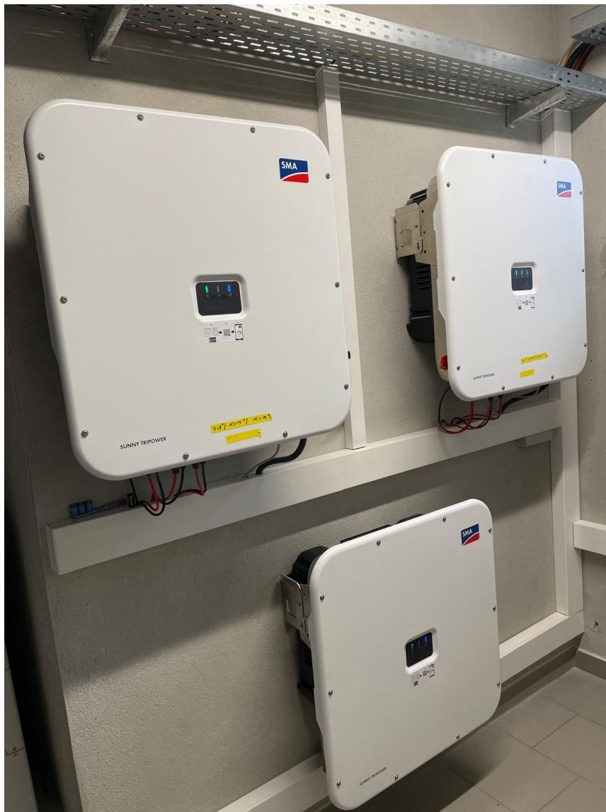
2x 20KWp Wechselrichter 1x 12KWp Wechselrichter
