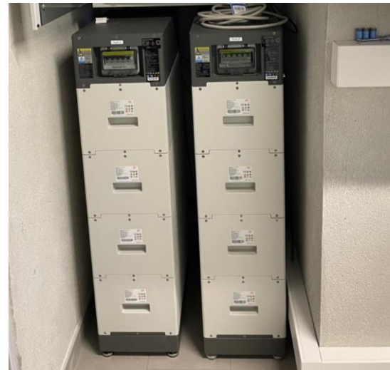
1x 6KW Batteriewechselrichter 2x 11KWh Batteriespeicher
